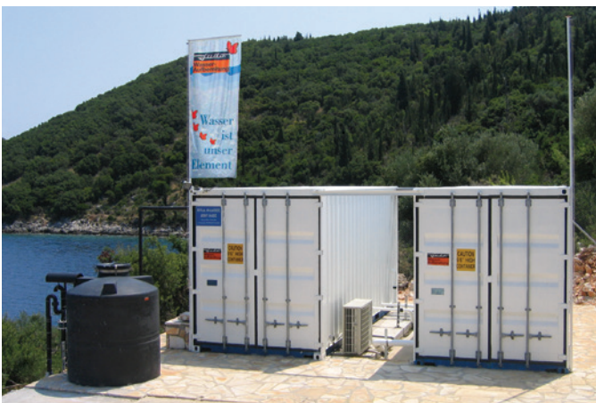
Meerwasserentsalzung in Containerbauweise
